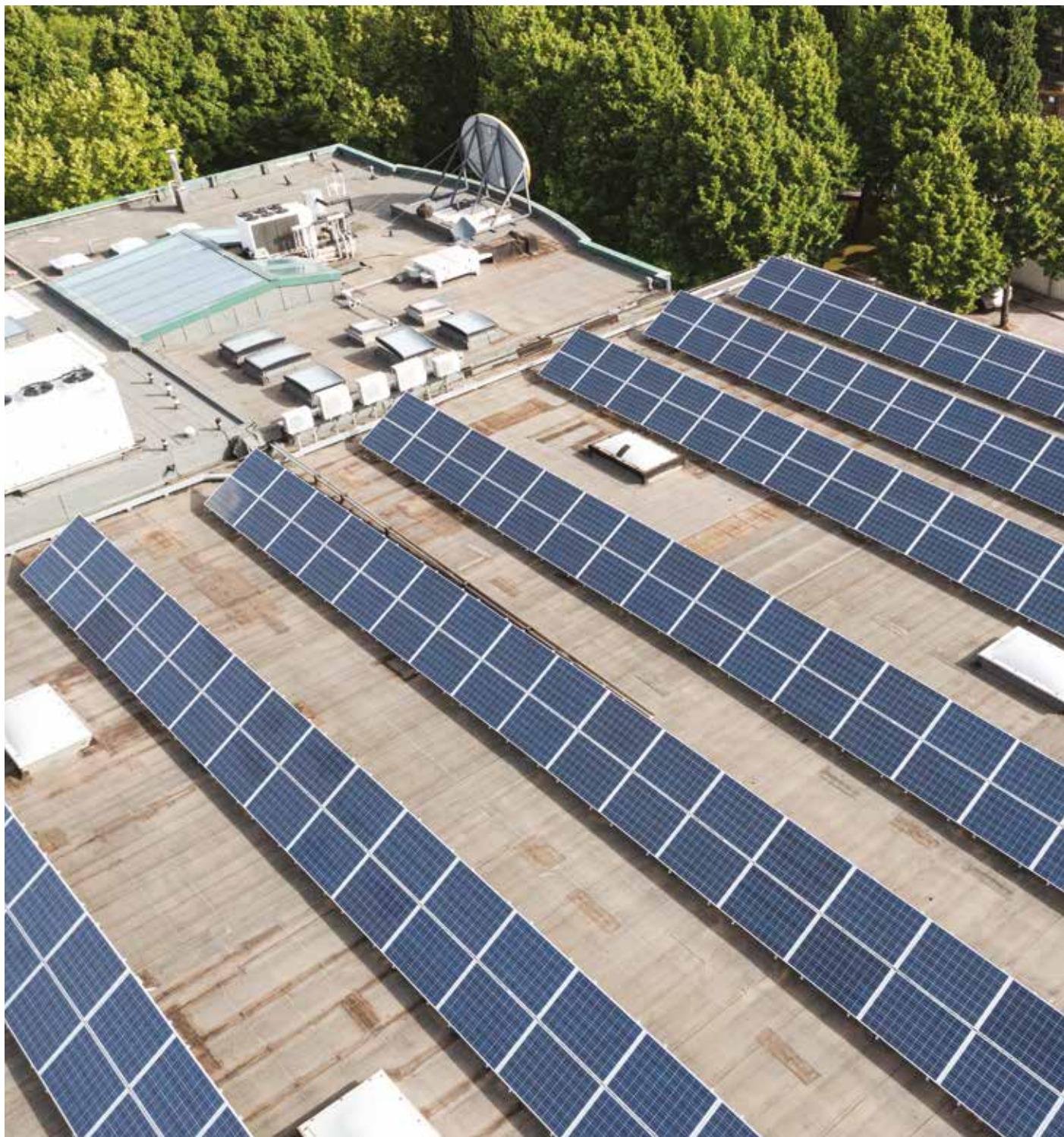
Impianto fotovoltaico Olitalia
