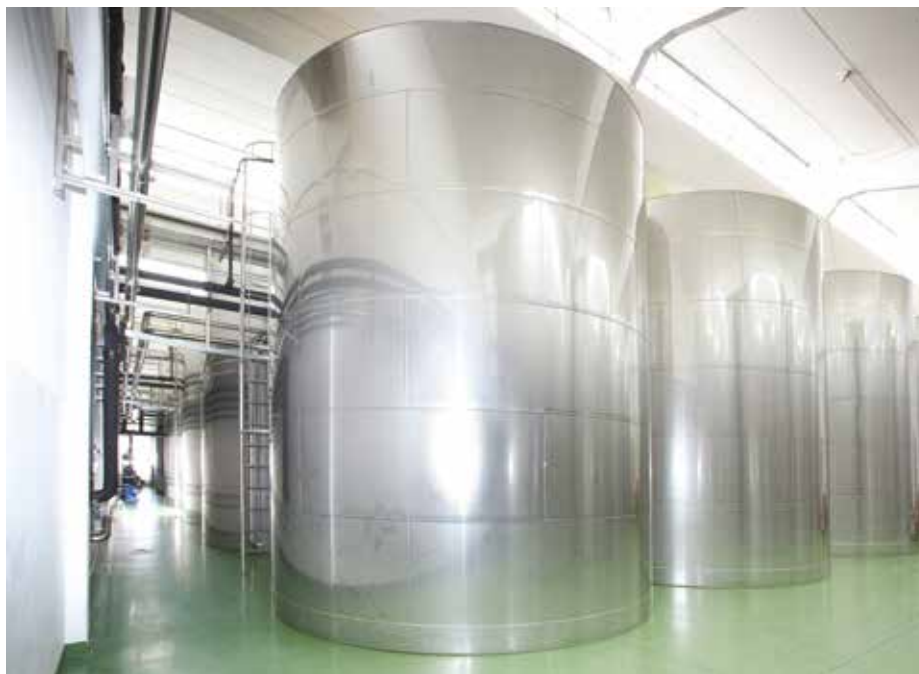
Magazzino B: cisterne coibentate
